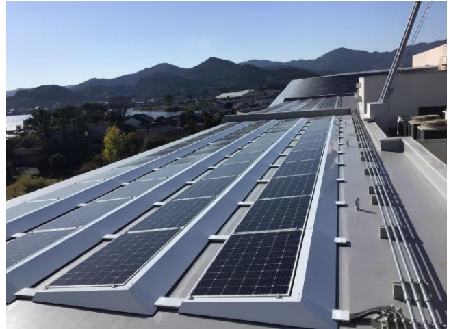
図5 三ヶ日協働センター 屋上パネル
