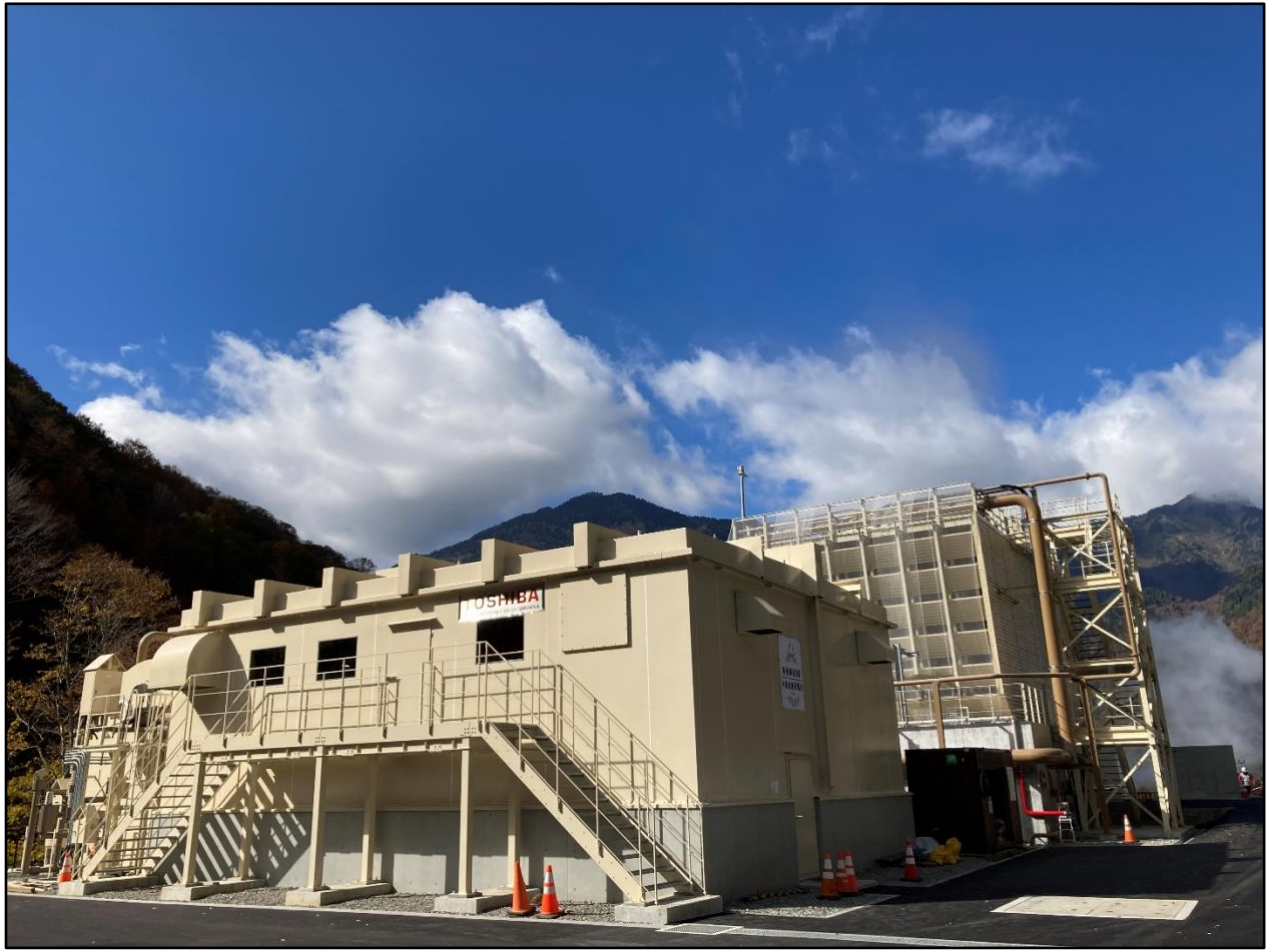
タービン・発電機建屋（左手前）・冷却塔（右奥）
