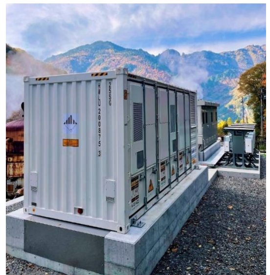
コンテナ型蓄電池
